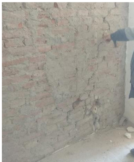
Pukotine širine veće od 10 mm
